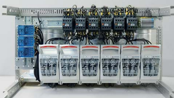
Вид модуля со стороны предохранителей
